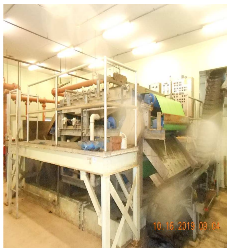
Kinzua WWTP - Sludge Press
