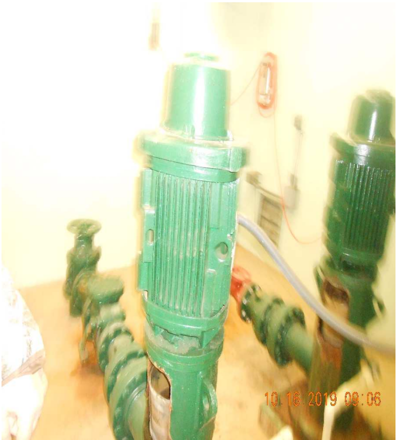
Kinzua WWTP - Effluent Pumps
